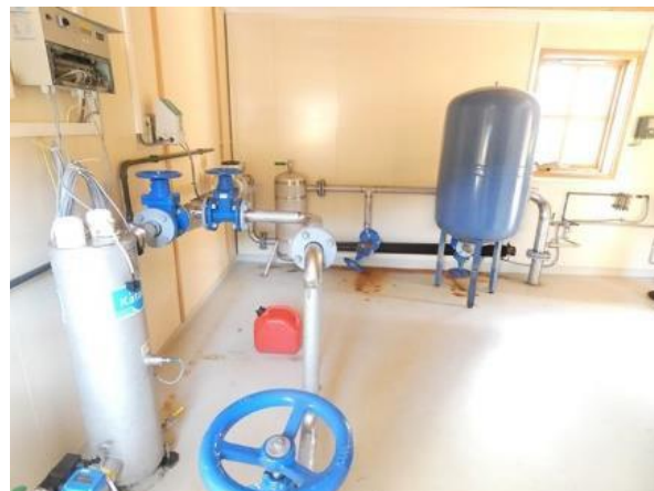
Figur 5 Utstyr i vannbehandlingsanlegget på Ose
