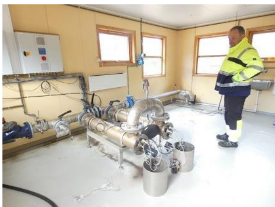
Figur 16 UV utstyr Bygland Vannverk
