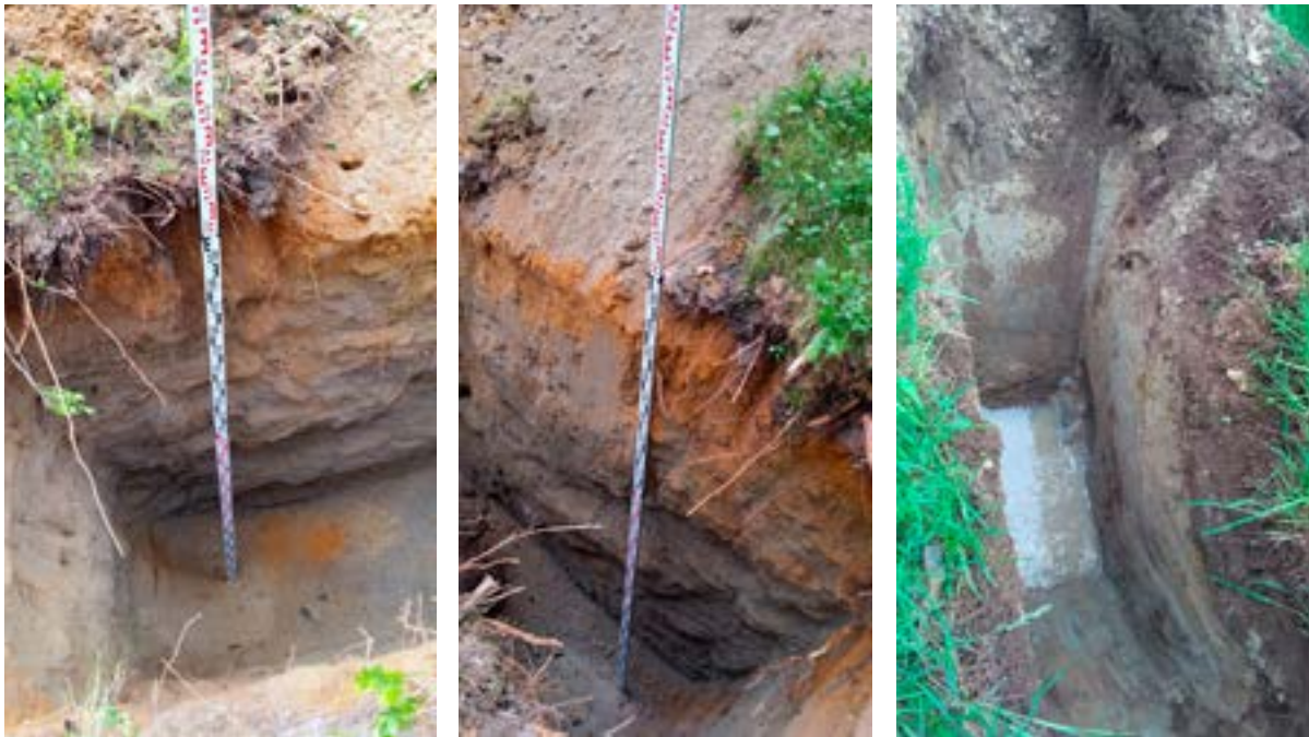
Figur 3.7: Sjakting med gravemaskin - eksempler på lagdeling i løsmasser. Øvre løsmasser har mindre lagringsfasthet enn de underliggende, fastere massene, og er dermed bedre egnet for etablering av infiltrasjonsfilter. Rustbrune løsmasser har generelt god fosforbindingskapasitet.
